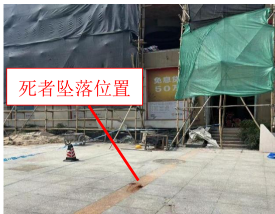
图 7 事故脚手架位置及死者坠落位置
