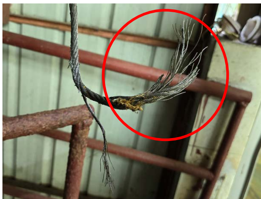
图 10 设备钢丝绳断裂脱钩
