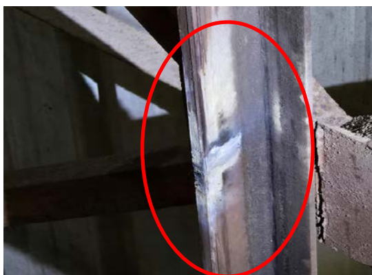
图 9 新的电焊电弧烧伤痕迹
