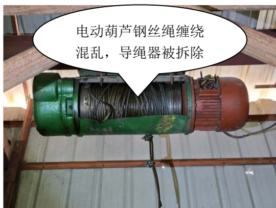
图 14 钢丝绳排绳紊乱
