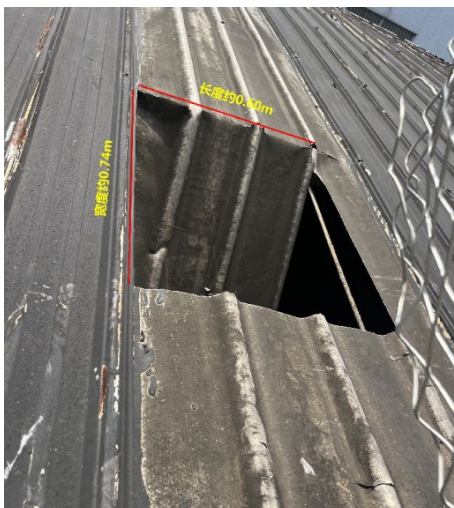
图 5 棚顶坠落口情况
