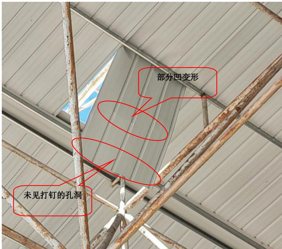
图 9 付剑坠落留下的缺口
