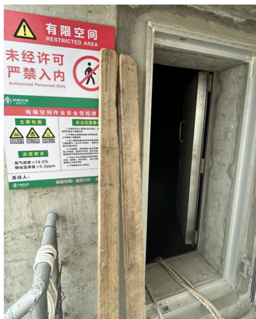
图 5 筒仓入口有限空间告知牌
